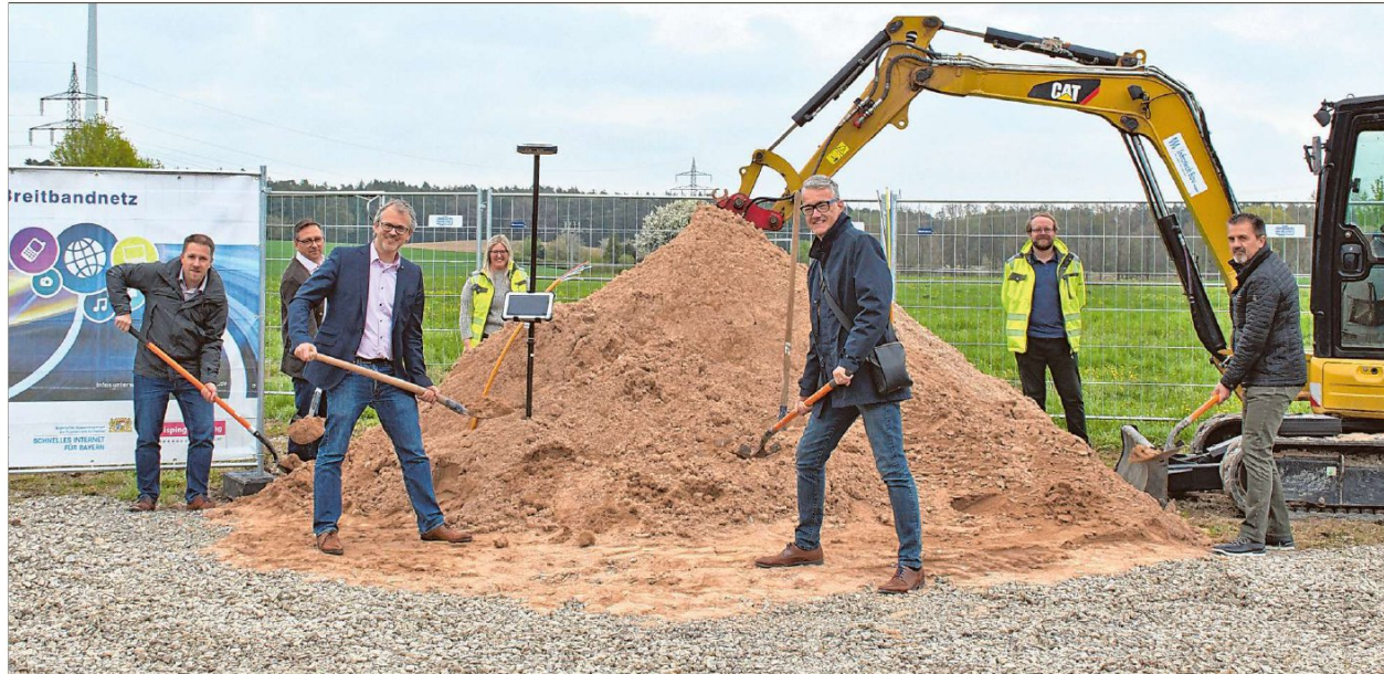
Beim symbolischen Spatenstich zum Auftakt des dritten Breitbandausbau-Verfahrens in Feuchtwangen (von links): Florian Frey von den Stadtwerken, Technischer Werkleiter Lothar Beckler, Geschäftsführer Johannes Bisping von der Netzbetreiberfirma, Bauleiterin Merle Belusa, Bürgermeister Patrick Ruh, Alexander Arez vom Planungsbüro und Stadtrat Thomas Ackermann. Foto: Rebecca Weber
